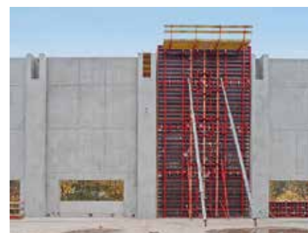
Triple rehausse, réalisée sous forme d'unité complète, et économie d'une console de travail du côté opposé. Scène du théâtre national, Stuttgart
