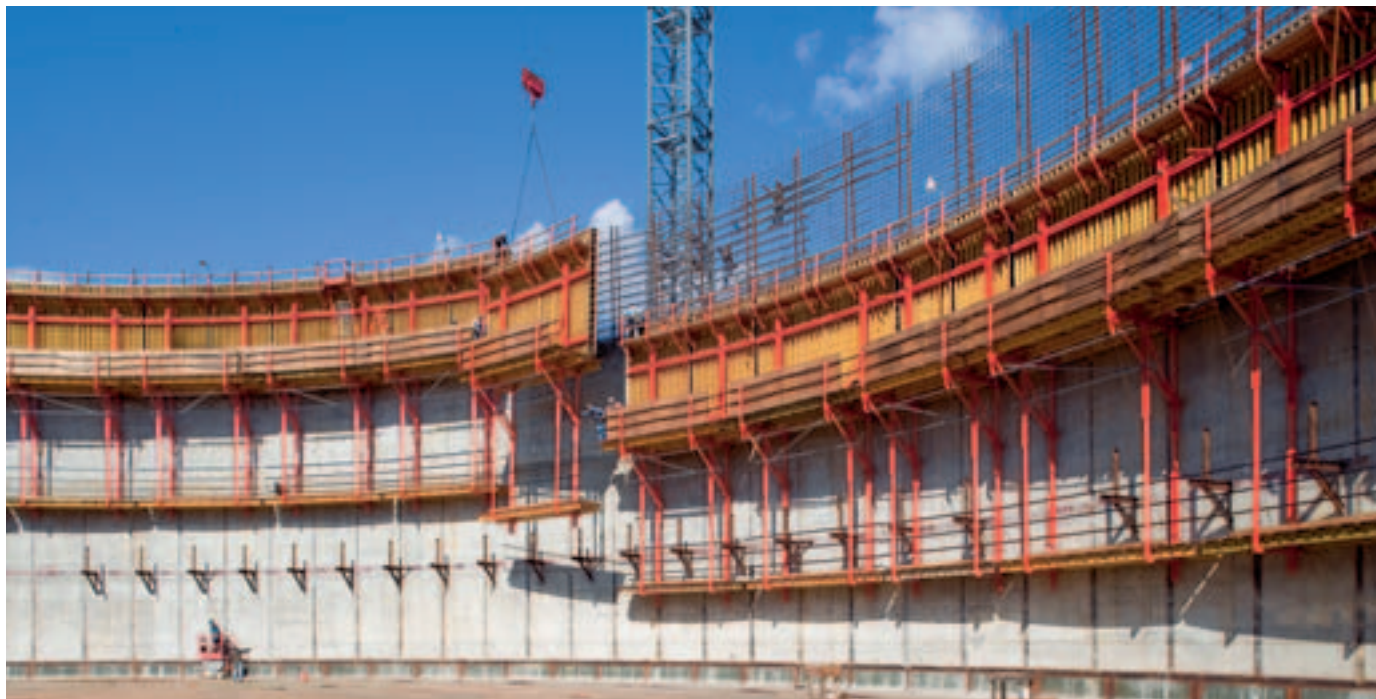
Réservoirs de gaz liquide Voiles circulaires Ø 77,50 m avec CB 240 et VARIO GT 24.
