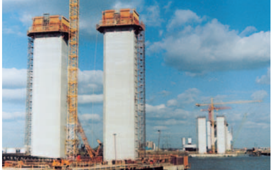
CB 240 avec coffrage de voiles VARIO GT 24 lors de la construction de piles de pont.
